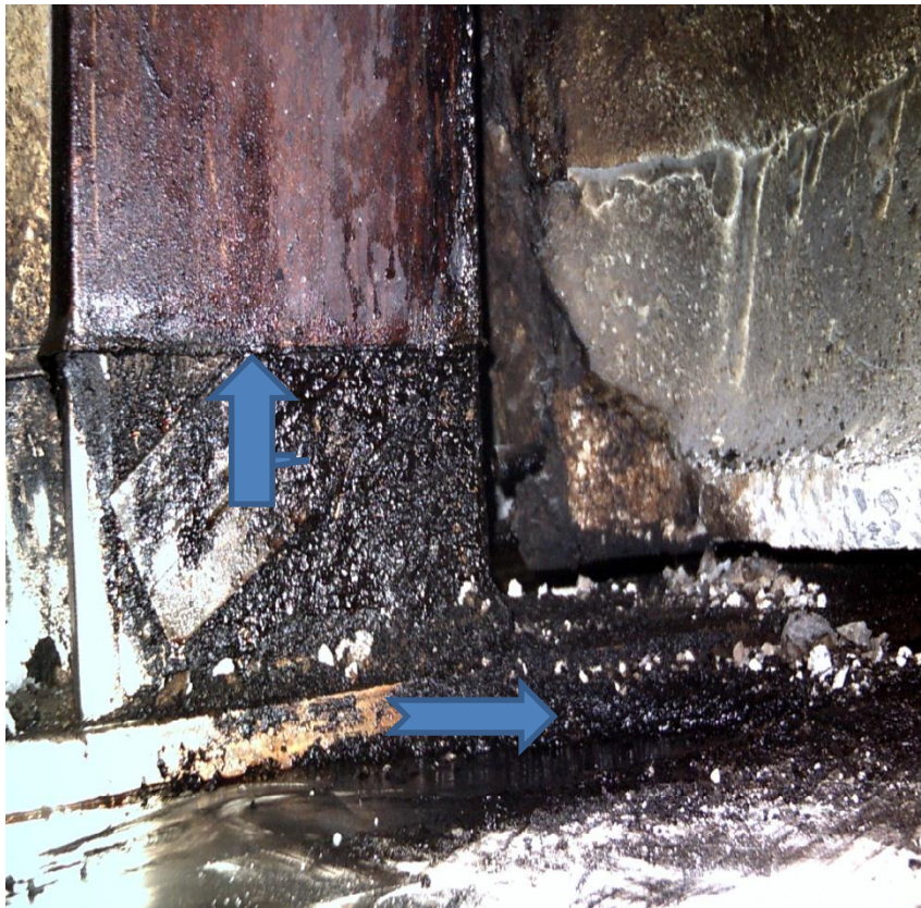
TRANSFERENCIA DEL DUCTO SUCIO Y SIN SELLAR
